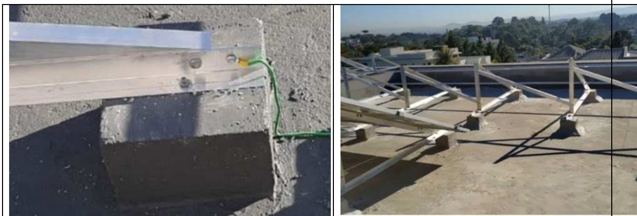
Figura 17 – Exemplo de sapatas de concreto para instalação da estrutura dos módulos na laje. Sapata com Largura = 20 cm; Profundidade = 20 cm; Altura = 15 cm
